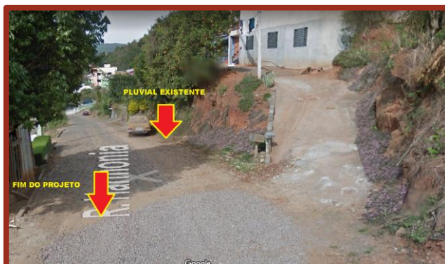
Figura 9 – Deságue em caixa existente
